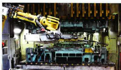
プレスの保守点検 Maintenance of press machine 冲压机的保养点检
